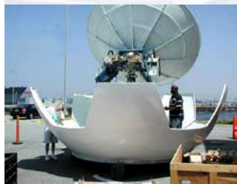
Montaje del VSAT para el Okeanos Explorer en el astillero de Fairhaven en Bellingham, WA, 2007. Imagen: Installation and Operation Manual for Sea Tel Model14600-75 Phase Matched C-Band TX/RX Antenna.
